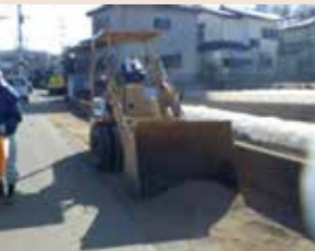
道路に流出した土
