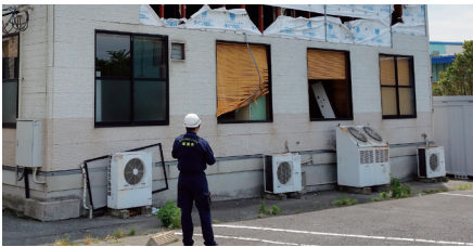
被災住宅の調査を行う市職員
