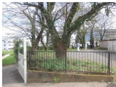
通用門から境界に沿ってのサクラ並木。根の伸長により、手前の擁壁にクラックが発生。（第三中学校）
