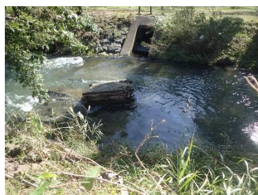
大雨の後、浮き上がった護床
