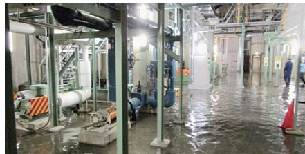
浸水した水再生センター
