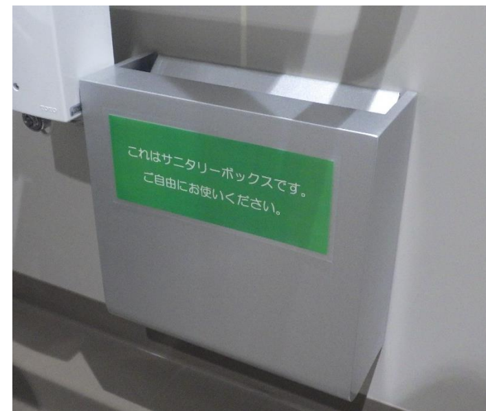
本庁舎内設置済みのサニタリーボックス
