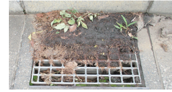
泥や落ち葉が詰まった雨水ます
