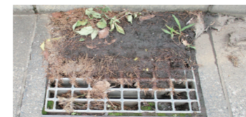
泥や落ち葉が詰まった雨水ます
