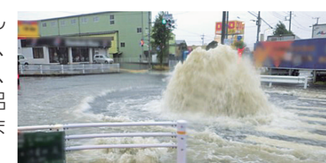
マンホールからの噴出
