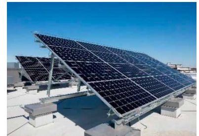
公共施設に設置された太陽光発電システム
