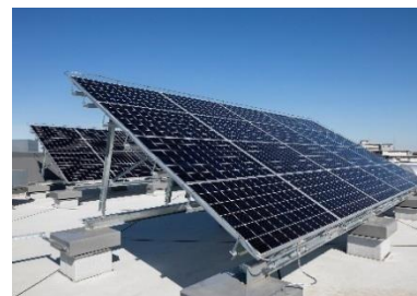
公共施設に設置された 太陽光発電システム
